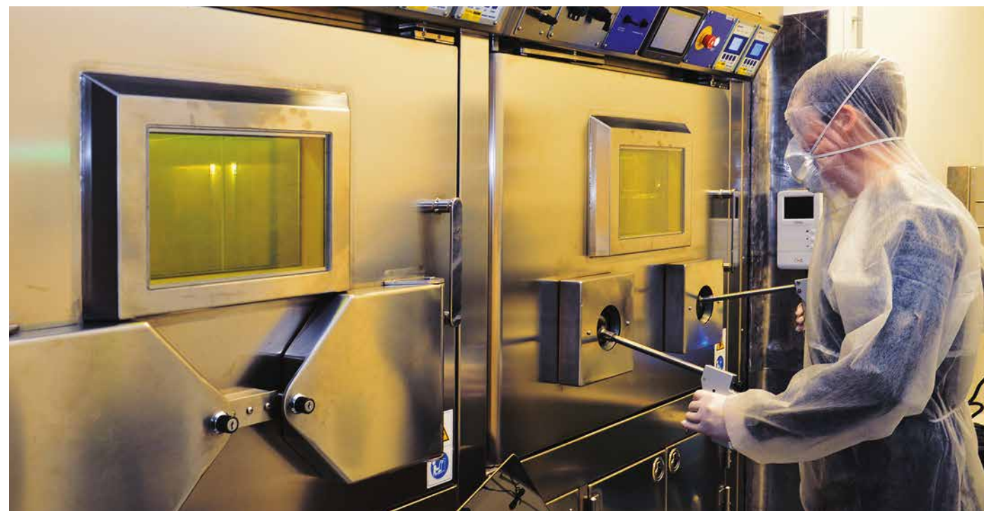
Процесс приготовления препарата на основе йода-131 в радиационно-защитном двухсекционном боксе для лечения заболеваний щитовидной железы. Персоналу обеспечен высокий уровень радиационной безопасности, работы проводятся при помощи дистанльных манипуляторов
